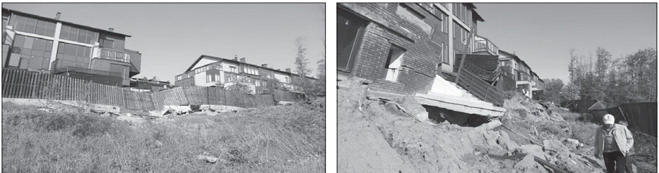
Рис. 1. Разрушения зданий и деформация склона в районе пос. Барвиха Московской обл.
